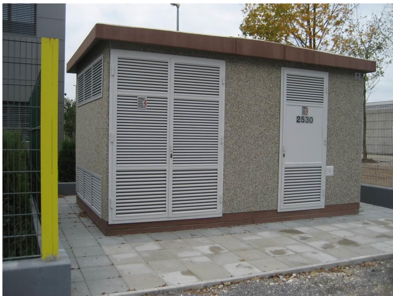
SLIKA 3. SAMOSTOJEĆA TRANSFORMATORSKA STANICA 1X2000 KVA
