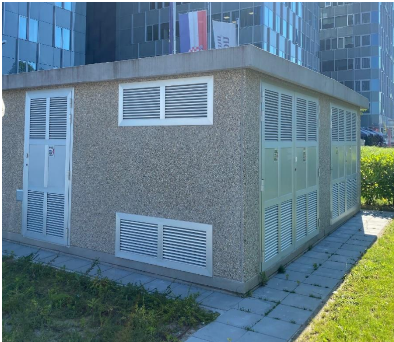
SLIKA 6. SAMOSTOJEĆA TRANSFORMATORSKA STANICA 2X2000 KVA
